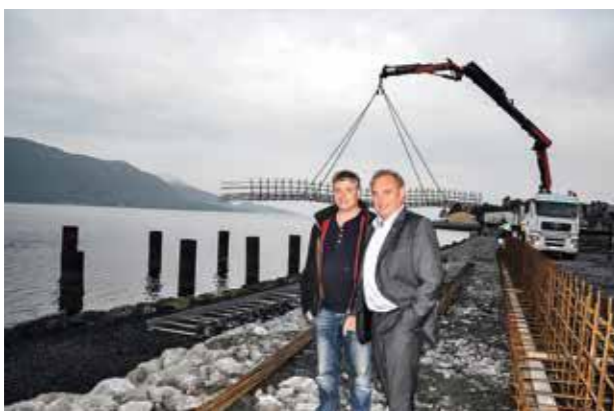
Den nye allmenningskaia på Aursneset skulle etter planen stå ferdig i 2007. Røyra som stikk opp av sjøen, har vist kvar kaia skal plasserast, men heile prosjektet har stått i stampe. – Etter iherdig jobbing er arbeidet med kaia i gang igjen. I november skal den vere ferdigstilt, fortalde ordførar Petter Lyshol og dagleg leiar i Storfjordterminalen, Bjørn Idar Lyngvæer i september. Foto: Monica Aure.
